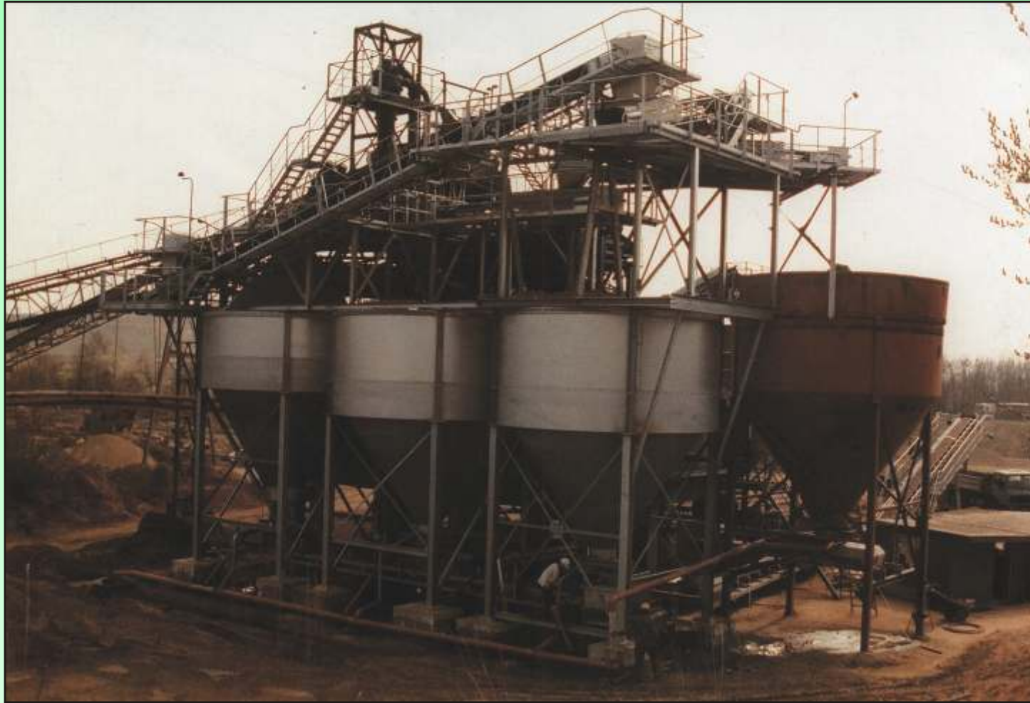
Kieswerk für eine Aufgabenleistung von 200 t/h. Sandgewinnung durch ein Schöpfra und Zyklon-Anlage.
